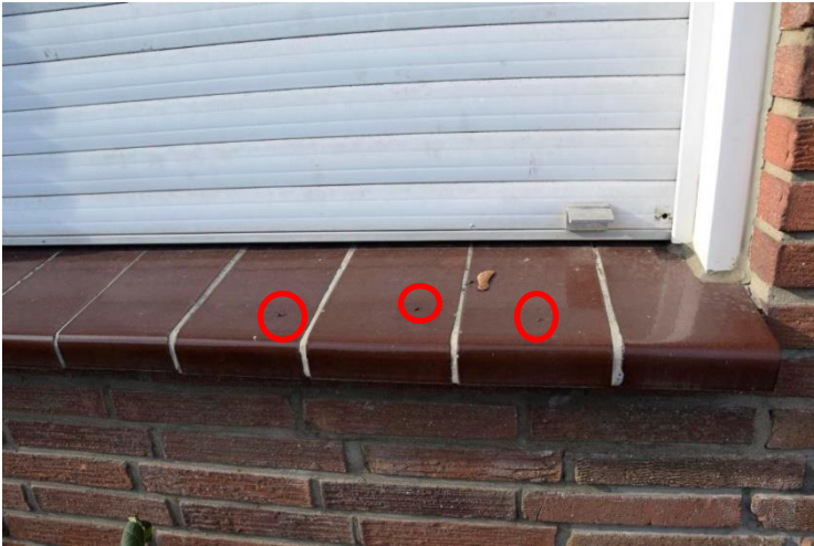
Auf einem Fensterbrett wurde an mehreren Stellen Zwergfledermauskot nachgewiesen.
